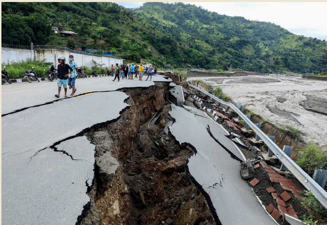
Una carretera partida en dos tras las inundaciones en Dili, Timor Oriental, en abril de 2021. Decenas de personas perdieron la vida y otras muchas desaparecieron cuando las inundaciones y los deslizamientos de tierra provocados por las lluvias torrenciales azotaron el este de Indonesia y Timor Oriental. Crédito de la foto: Antonio Dasiparu/EPA-EFE/Shutterstock
